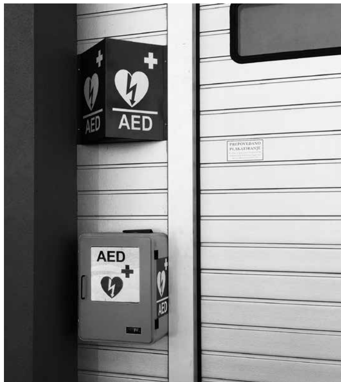
SLIKA 2: ENOTNO OPREMLJEN JAVNO DOSTOPNI AED NA GASILSKEM DOMU V TREBNJEM
